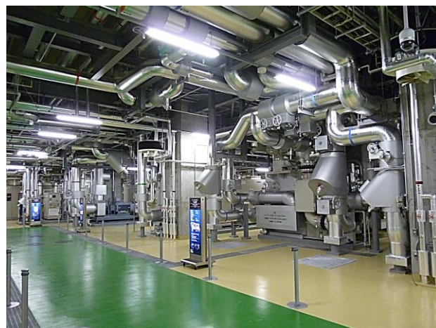
トップレベル事業所に認定された東京スカイツリー地域熱供給施設
