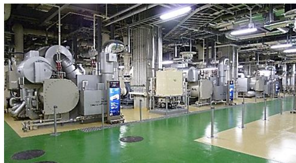
ターボ冷凍機 (メインプラント内)
