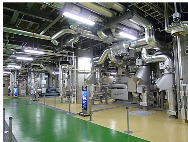
東京スカイツリー地域熱供給施設
