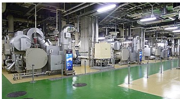
ターボ冷凍機 (メインプラント内)
