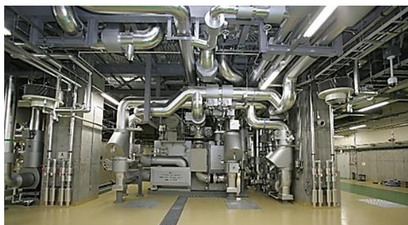
ヒートポンプチャラー (熱回収型)
