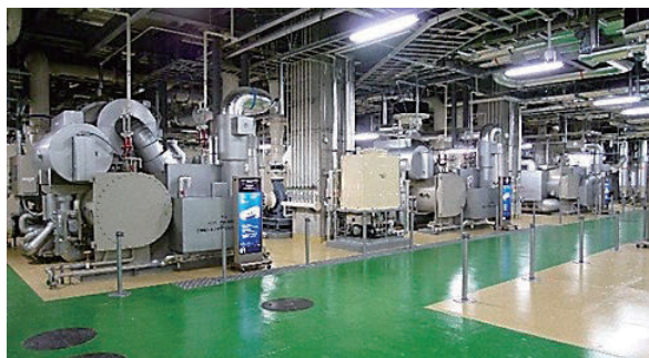
ターボ冷凍機 (メインプラント内)
