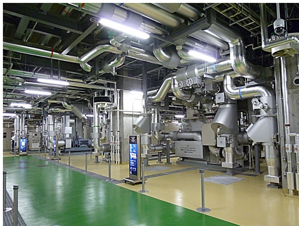
認定の更新を受けた東京スカイツリー地域熱供給施設
