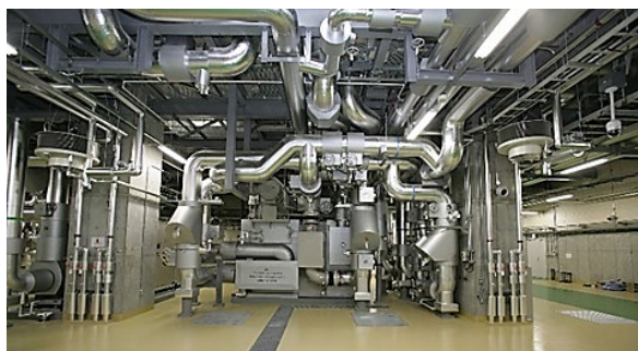
ヒートポンプチラー (熱回収型)
