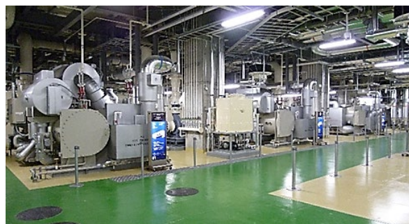
ターボ冷凍機（メインプラント内）
