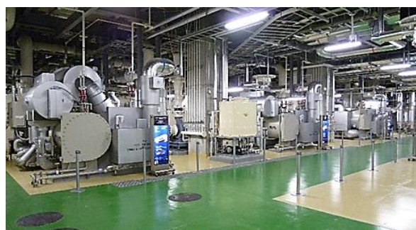
ターボ冷凍機（メインプラント内）
